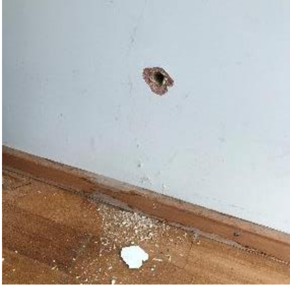
Abbildung 47: HXX | Loch, welches durch falschen Bohren der Gerüstverankerung entstanden ist
