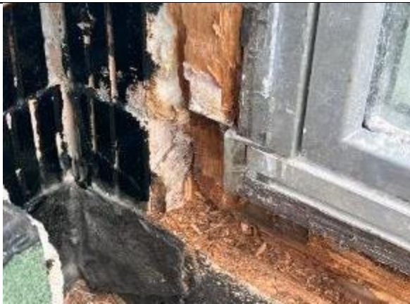
Abbildung 5: HXX | Sockelbereich Fenster Terrasse vor der Sanierung, bzw. nach Öffnung und Freilegung
