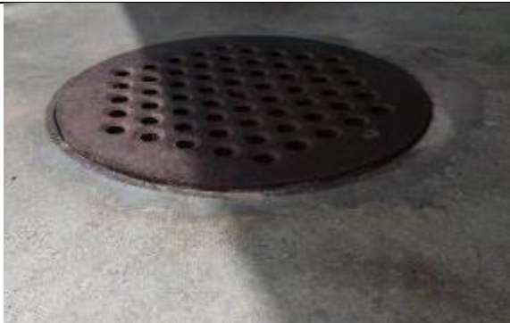
Abbildung 51: Tiefgarage | Schachtdeckel mit Gummidichtung unterlegt, um Bewegungen des Deckels zu vermeiden
