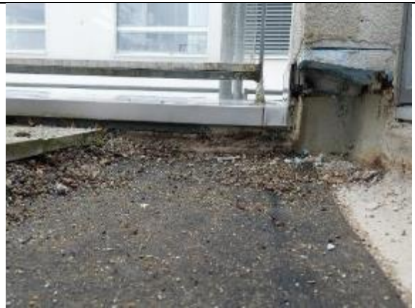
Abbildung 6: HXX | Anschluss Geländer-Aussenwand vor der Sanierung, bzw. nach Öffnung und Freilegung
