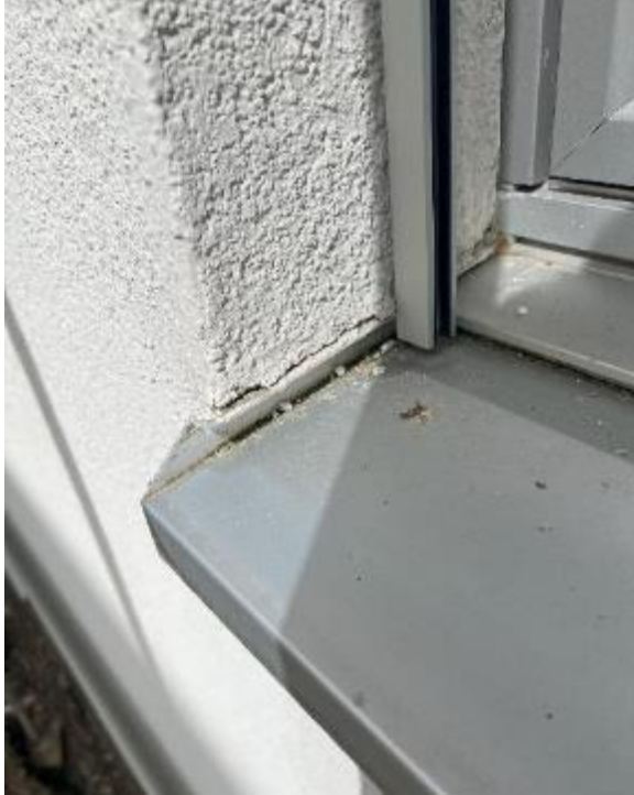
Abbildung 31: HXX | Anschluss Fensterbank-Putzbord vor der Sanierung
