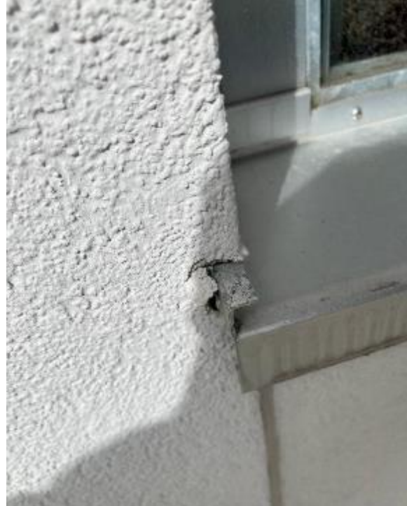
Abbildung 32: HXX | Anschluss Fensterbank-Putzbord vor der Sanierung
