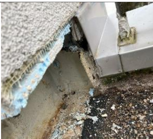
Abbildung 7: HXX | Anschluss Geländer-Aussenwand vor der Sanierung, bzw. nach Öffnung und Freilegung
