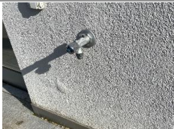
Abbildung 7: Terrasse T4 | Elektrodose/Wasserhahn
