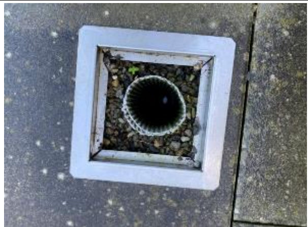
Abbildung 37: Terrasse T1 | Bodenablauf
