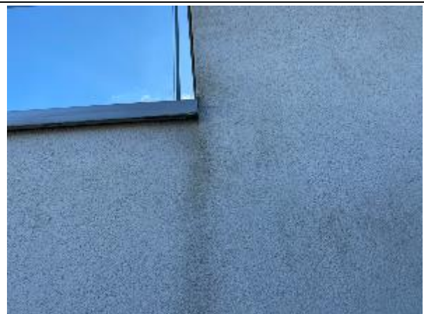
Abbildung 63: Terrasse T4 | Fassade/Fensterbank
