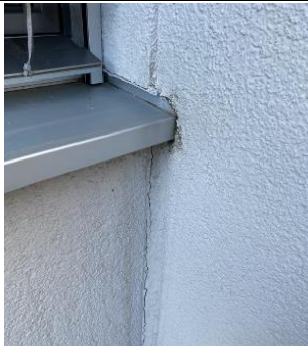
Abbildung 19: Terrasse T1 | Fassade/Fensterbank
