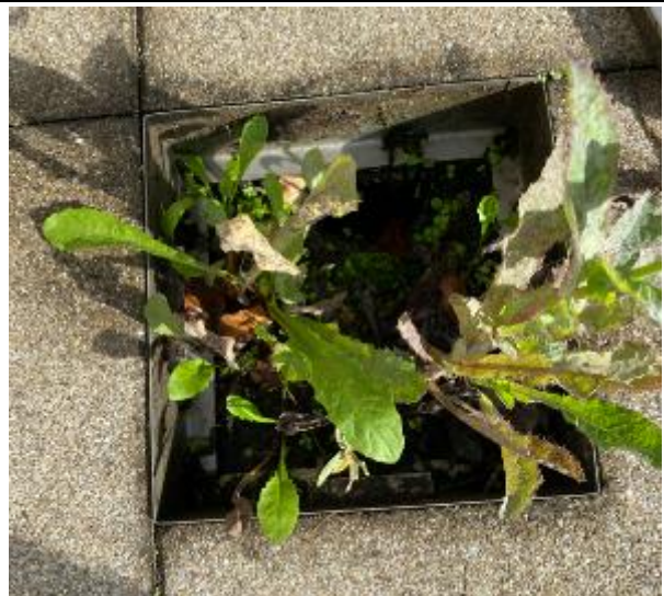
Abbildung 65: Terrasse T3 | Bodenablauf
