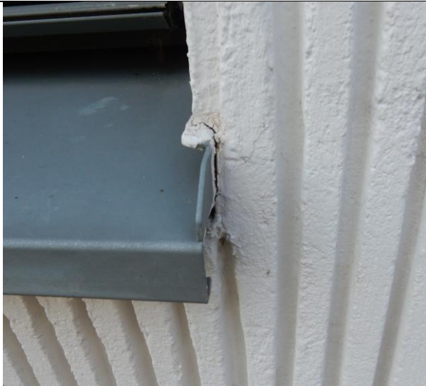
Abbildung 12: Die Fugenausbildung des Anschlusses ALU- Fensterbank – Putzsystem entspricht nicht den Vorgaben des Systemhalters und der SIA Norm 243:2008
