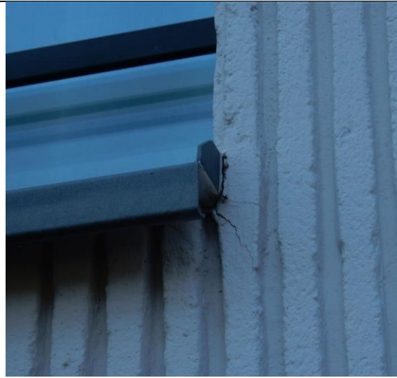
Abbildung 13: Die Anschlüsse des Kammputzes an die Putzborde der Fensterbänke weisen Risse von Zwängungen auf
