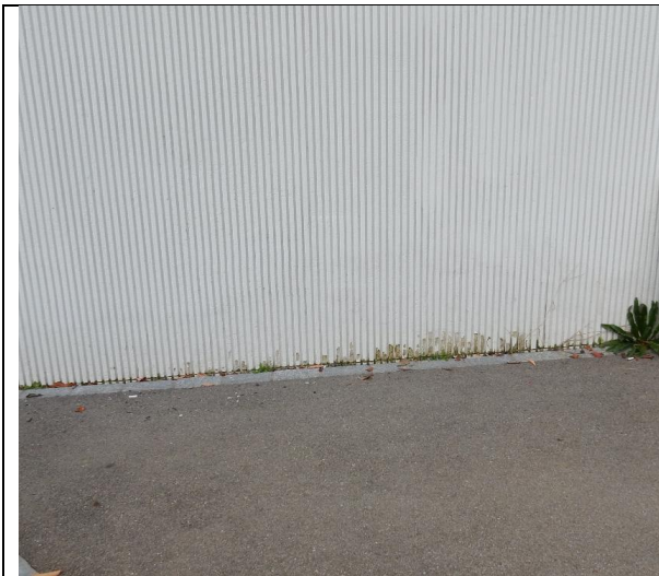
Abbildung 6: Der nachträglich ausgeführte Kapillarschnitt wurde nicht verfüllt.
