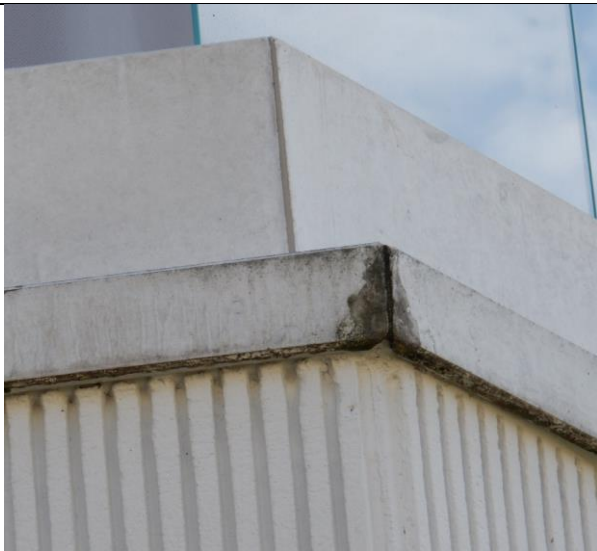
Abbildung 14: Die Kittfugen an den Ecken der Beton- Abdeckelemente der Loggiabrüstungen sind scheinbar nicht mehr intakt zu sein.
