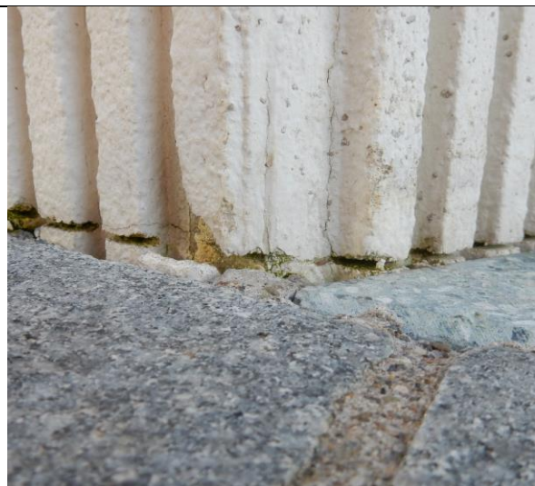
Abbildung 9: Neben den horizontalen sind auch vereinzelte vertikale Risse in derselben Breite vorhanden.
