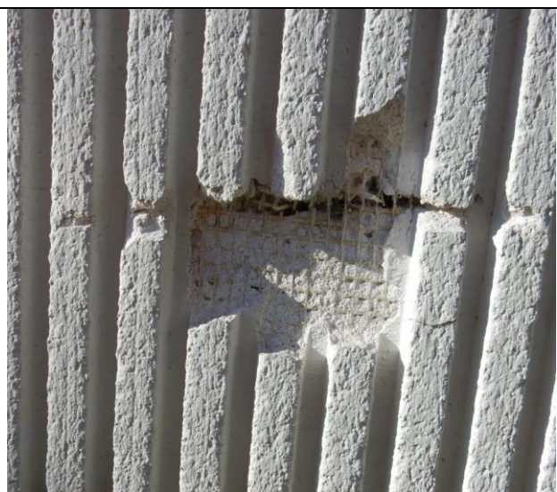
Abbildung 11: Mechanische Schäden stören die Mörtelstruktur des Kammputzes und sie vergrößern sich in Ausmass und Tiefe.
