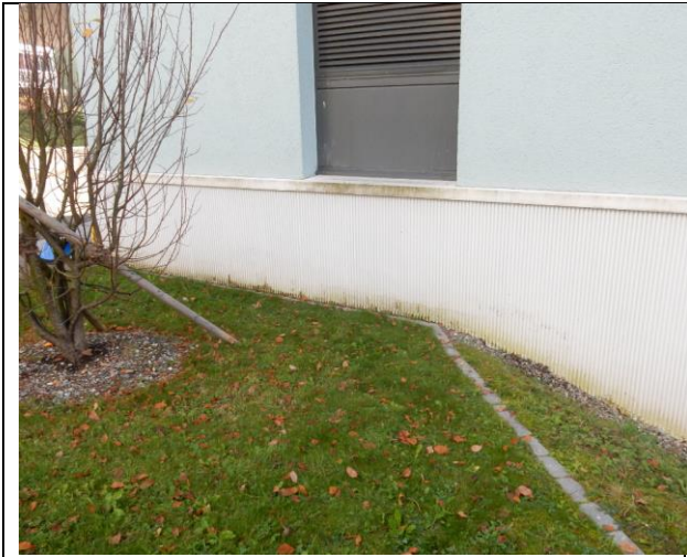
Abbildung 2: Der Deckputz wurde als Kammputz bis unter die Terrainlinie geführt.
