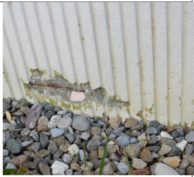
Abbildung 5: Im Bereich von mechanischen oder setzungsbedingten Schäden löst sich der Kammputz grossflächiger.
