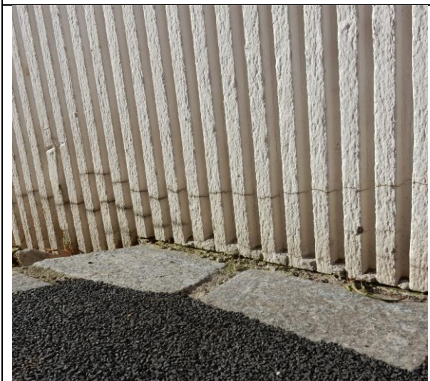
Abbildung 8: An zahlreichen Stellen sind ca. 15 bis 30cm oberhalb der Terrain- oder Belagslinie Risse von 0.1 – 0.3mm feststellbar.
