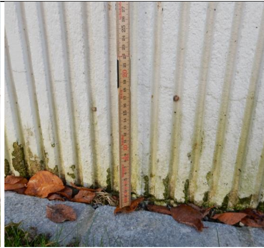
Abbildung 3: Es wurde kein Sockelschutz im Spritzwasserbereich angebracht.
