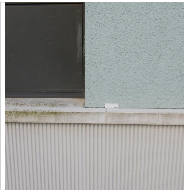
Abbildung 16: Die vertikalen Stösse sind mit Kittmasse verfüllt. Die Abdichtung gegenüber dem Putzsystem ist intakt wenn die Ausführung gemäss den Vorgaben der XXX ausgeführt wurden.
