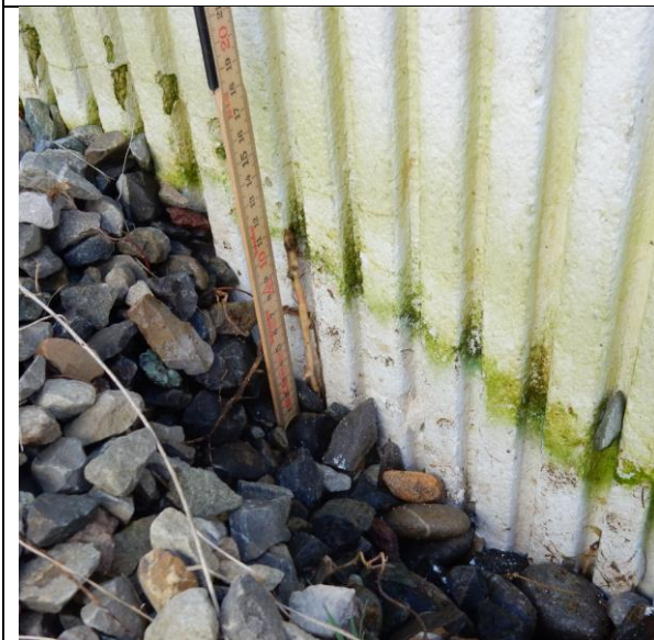
Abbildung 4: Im Spritzwasserbereich ist eine erheblich grössere Feuchtigkeit vorhanden. Dies führt zum Algen- und Pilzwachstum.
