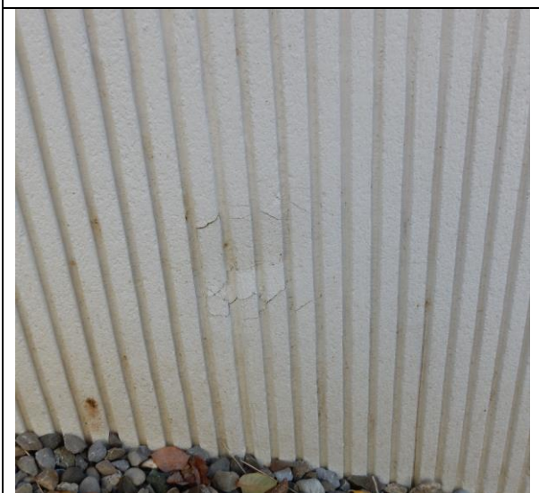
Abbildung 10: In der Sockelzone sind bereits etliche mechanische Beschädigungen zu verzeichnen.
