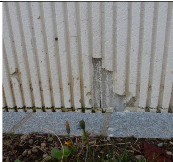
Abbildung 7: Oberhalb des Schnittes löst sich der Kammputz an vielen Stellen.
