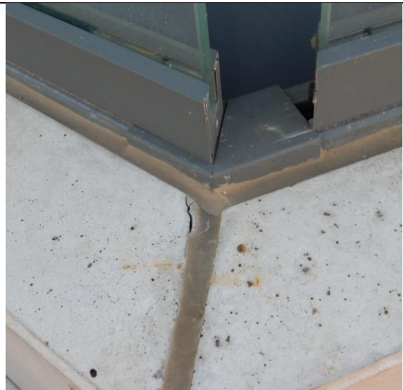
Abbildung 15: Diese Kittfuge mit Flankenablösung ist undicht. Die Abdichtung gegenüber dem Putzsystem ist uns nicht bekannt.
