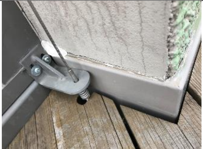
Abbildung 80: H2 | Leibung Fenstertüre
