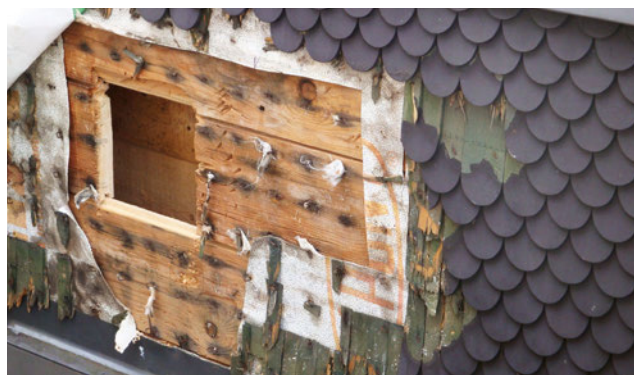
Ein zu dichter Farbstrich auf den Holzschindeln wirkt als Diffusionssperre. Hinter den Holzschindeln staut sich Wasserdampf an und führt zum Faulen des Holzes.
