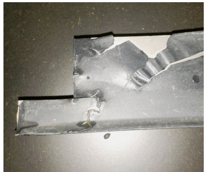
An einem Metallbauteil löst sich die Lackierung.
