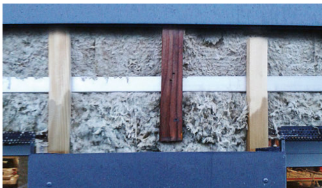
Durchnässte Holzlattung und Wärmedämmung trotz Hinterlüftung: Die EPDM-Fugenbänder wurden nicht gemäss Herstellervorgaben montiert.
