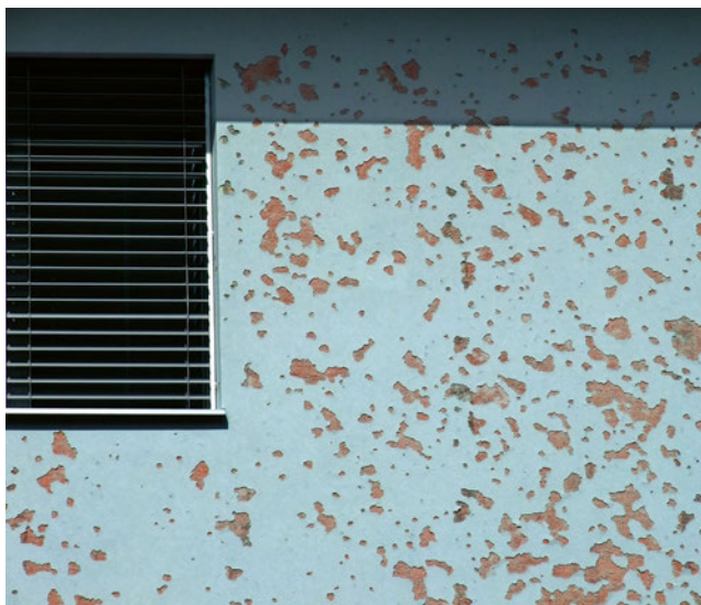
Hagelschäden am Verputz einer Fassade.
